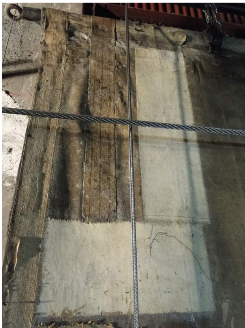
Détail des pièces de renfort en toile de coton ou sangle de jute.
